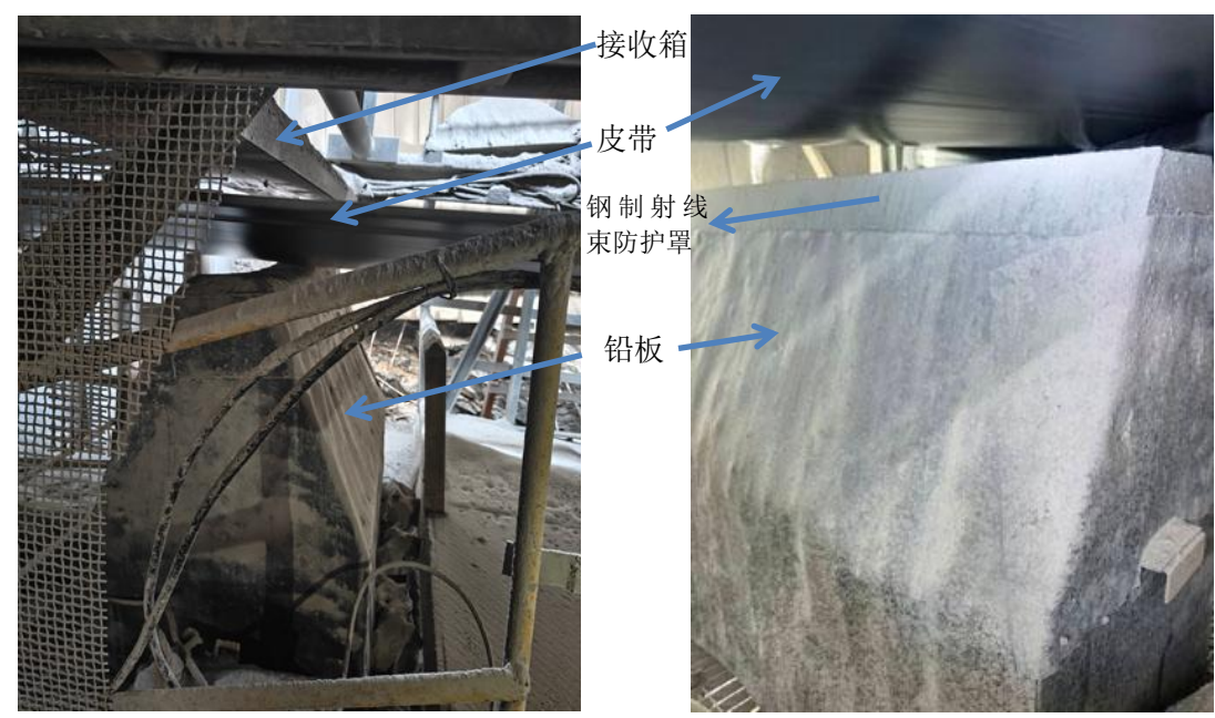
图 9-3 检测系统现场照片
