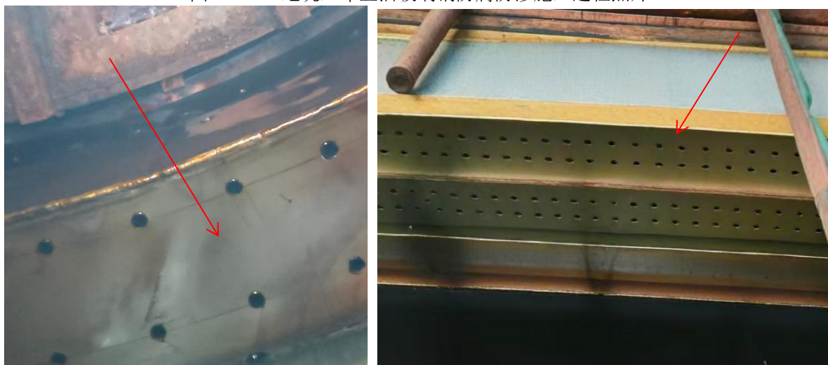
图 3.3-2 1#线井口槽边抽风图片
