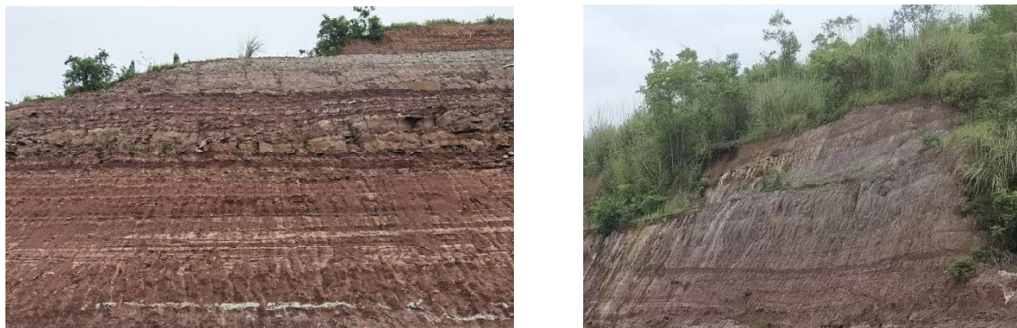
图 3.1.5-5 调查区局部裂隙发育照片
