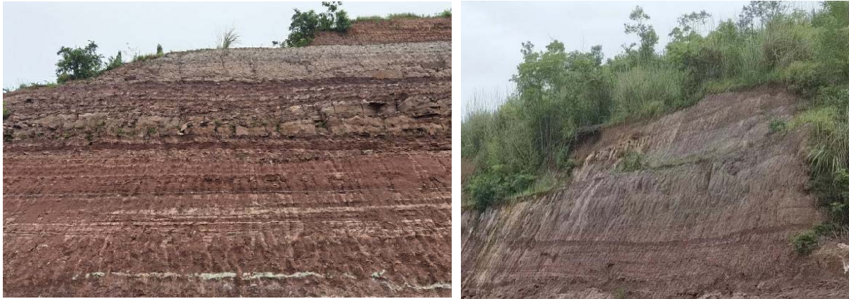
图 4.1.5-5 调查区局部裂隙发育照片
