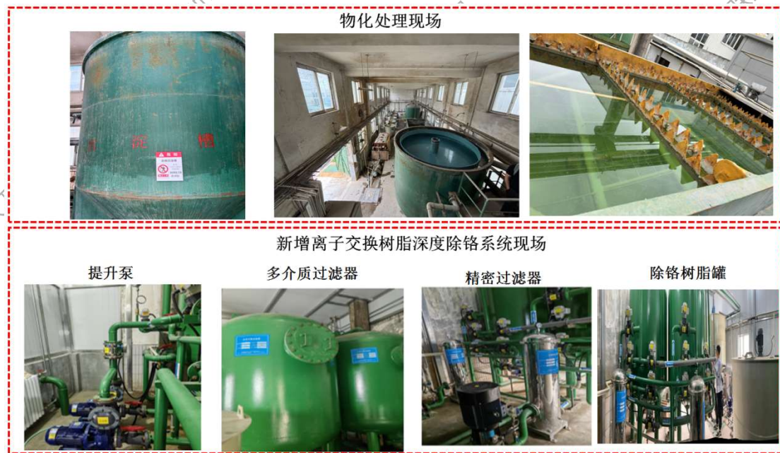
图 8.2-11 陕西宝光真空电器股份有限公司含铬废水深度处理现场实景
