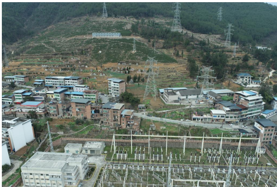
图 2-1 奉节 220kV 变电站 220kV 侧间隔现状 (从左至右为西至东方向)
