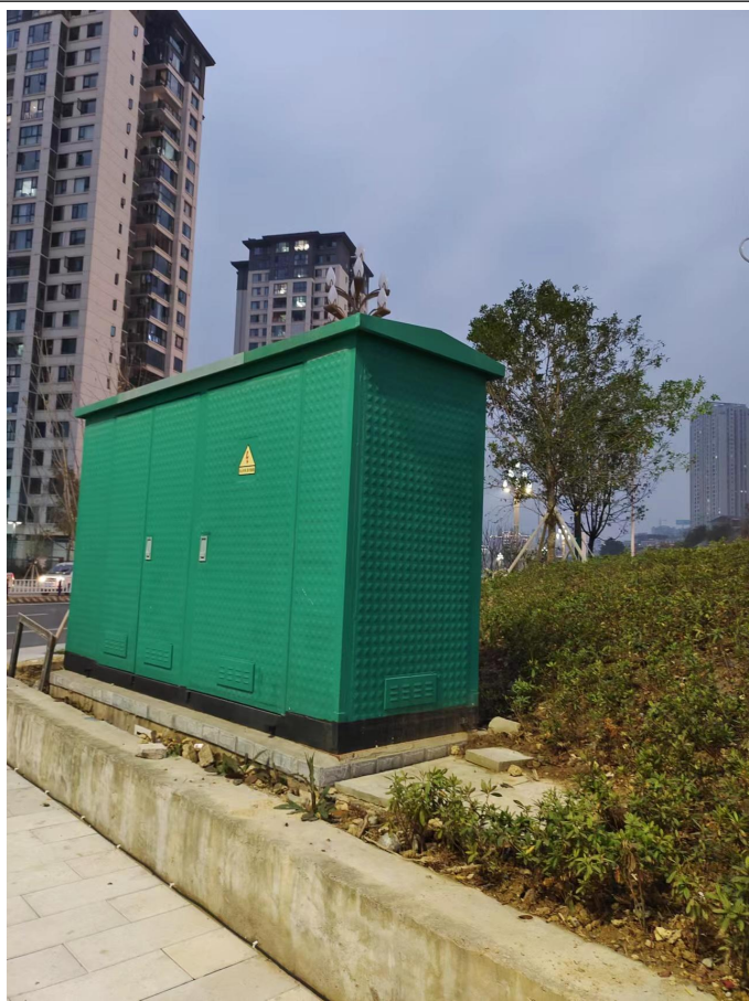
门诊住院综合楼东南侧市政配电箱
