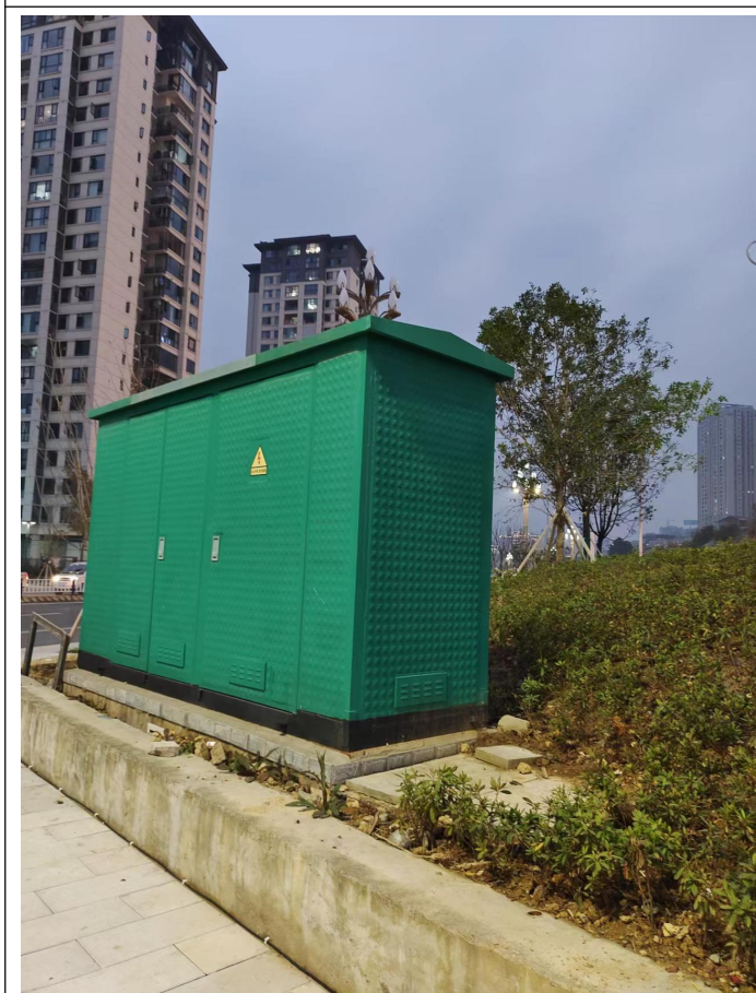
门诊住院综合楼东南侧市政配电箱
