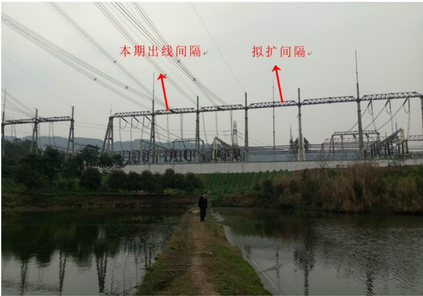
图 2-4 500kV 巴南变电站间隔出线现状
