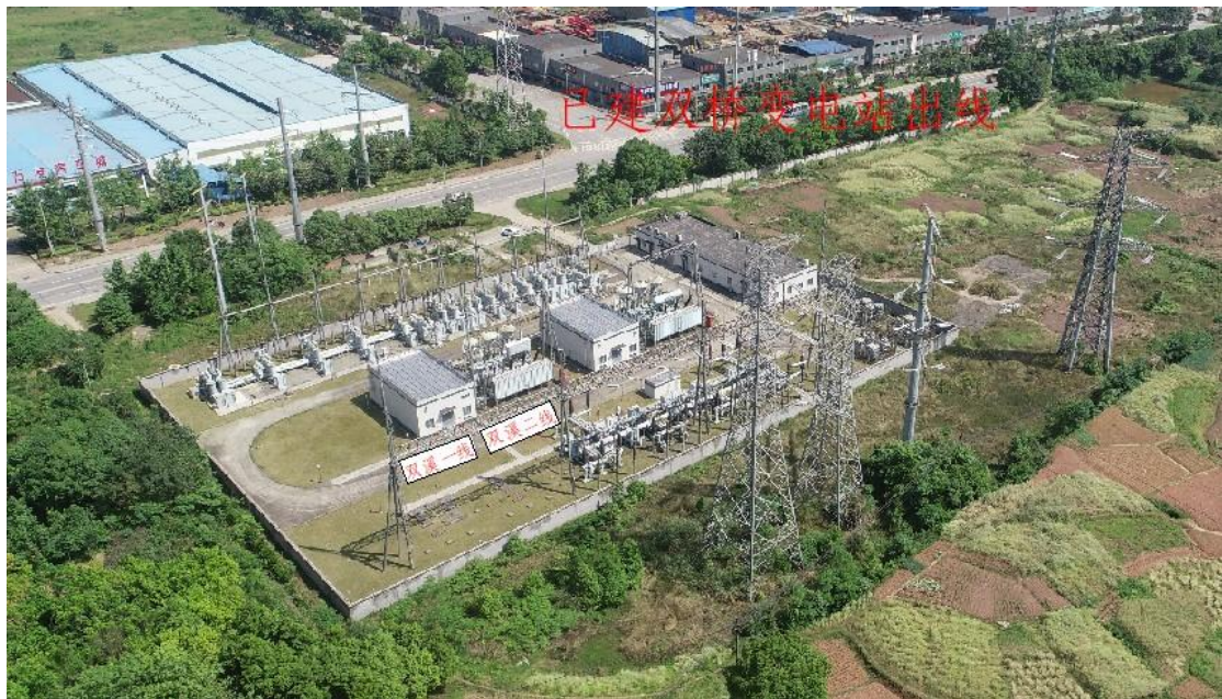
图 2-1 220kV 双桥变电站出线实景图
