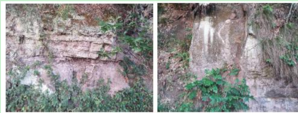
图 3.1-3 潼南工业园区东区内局部裂隙发育照片
