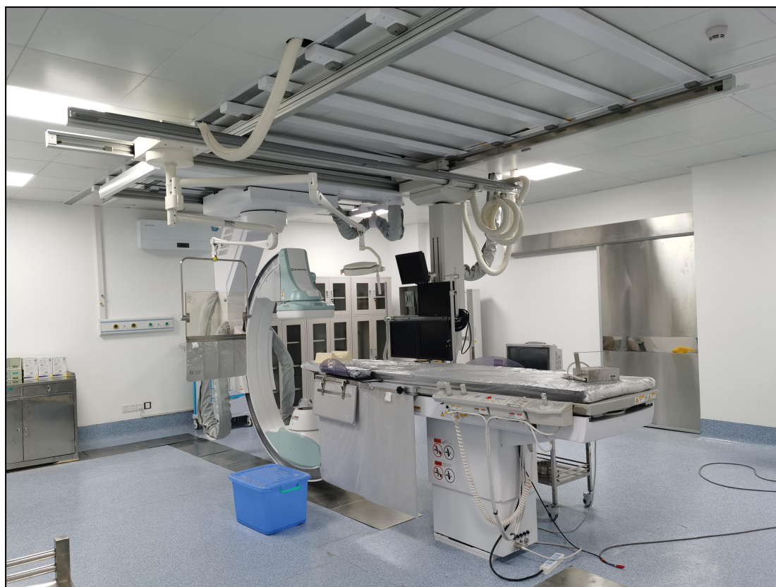
图 10-3 设备配置的辅助防护设施现场照片
