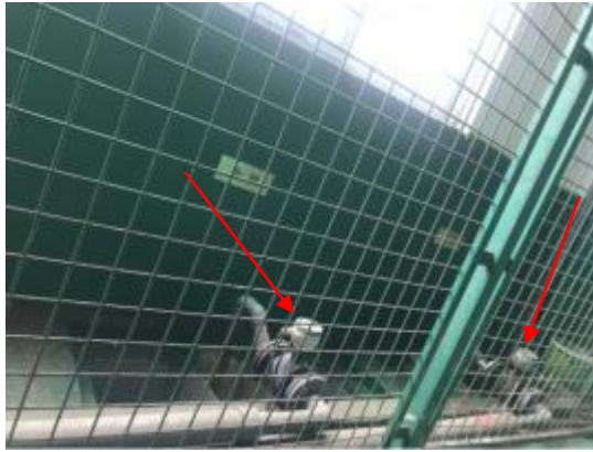
图 2.3-3 现有废水流量在线监控设备图
